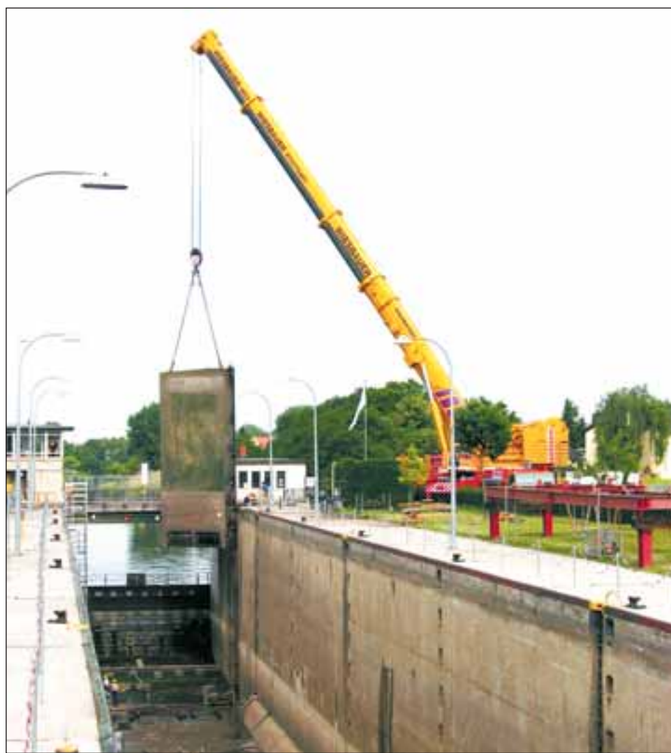
Wenn eine Schleuse repariert werden muss, ist das mit hohem Aufwand verbunden: So wird hier in Schwabenheim, wo ein 50 Tonnen schweres Stemm-tor ausgehoben wird. Foto: WSA
